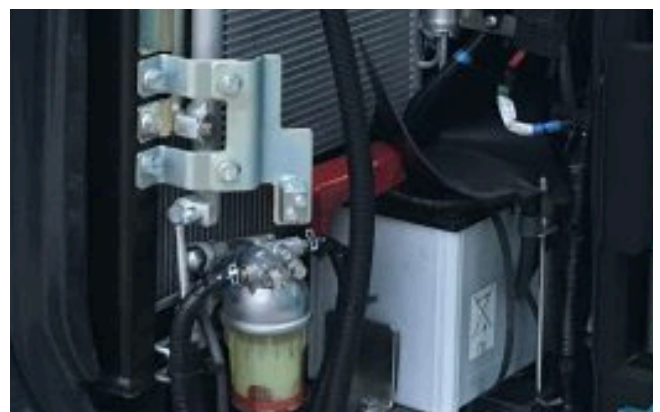
Batterifrånskiljaren innebär att underhåll kan utföras på ett säkert sätt.
